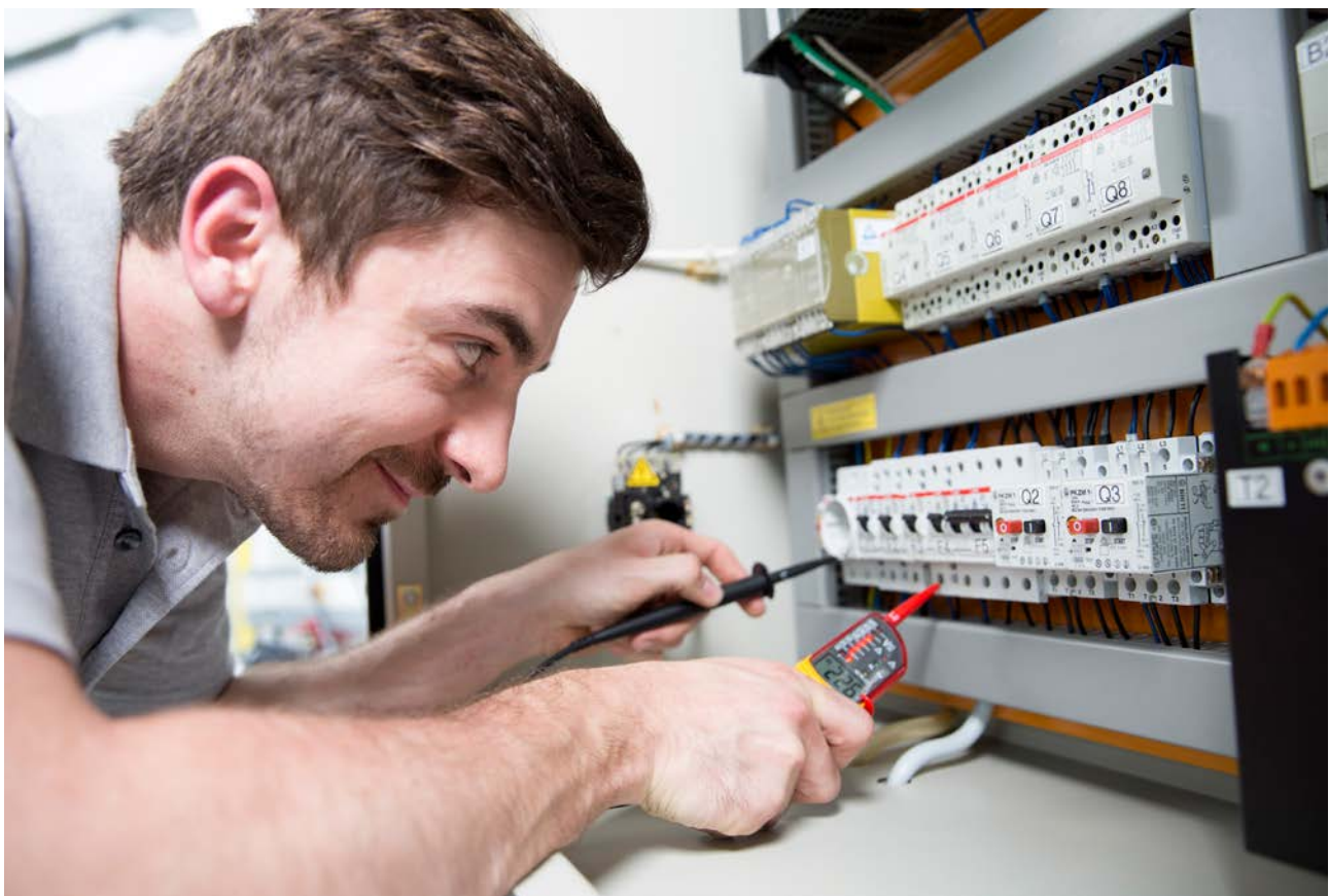
Abbildung 9: Messungen am Schaltschrank (Quelle: ZVEH)
